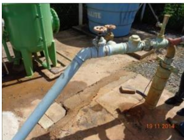
Foto 14 – Vista do poço de captação e da unidade de tratamento
