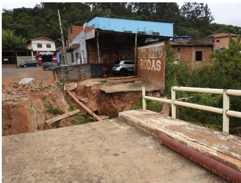
Foto 37 - Ocupação sobre área naturalmente suscetível a processos de solapamento e inundação do Córrego Areão
