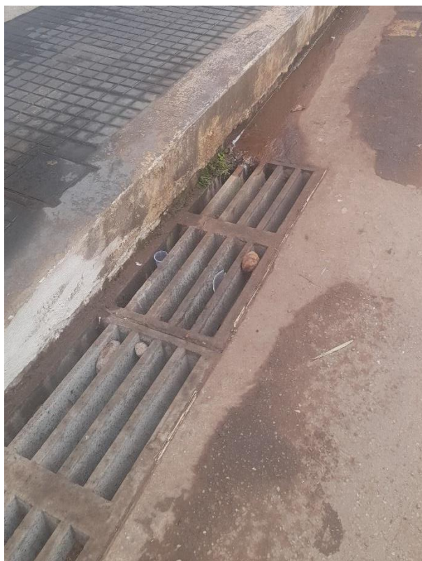
Foto 17 – Dispositivo de captação de água de chuva – boca-de-lobo
