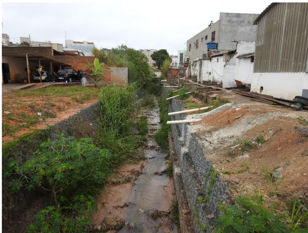
Foto 36 - Trecho do Córrego Areão com proteção de margem. Estrangulamento do canal e ampliação dos problemas de inundação para jusante.
