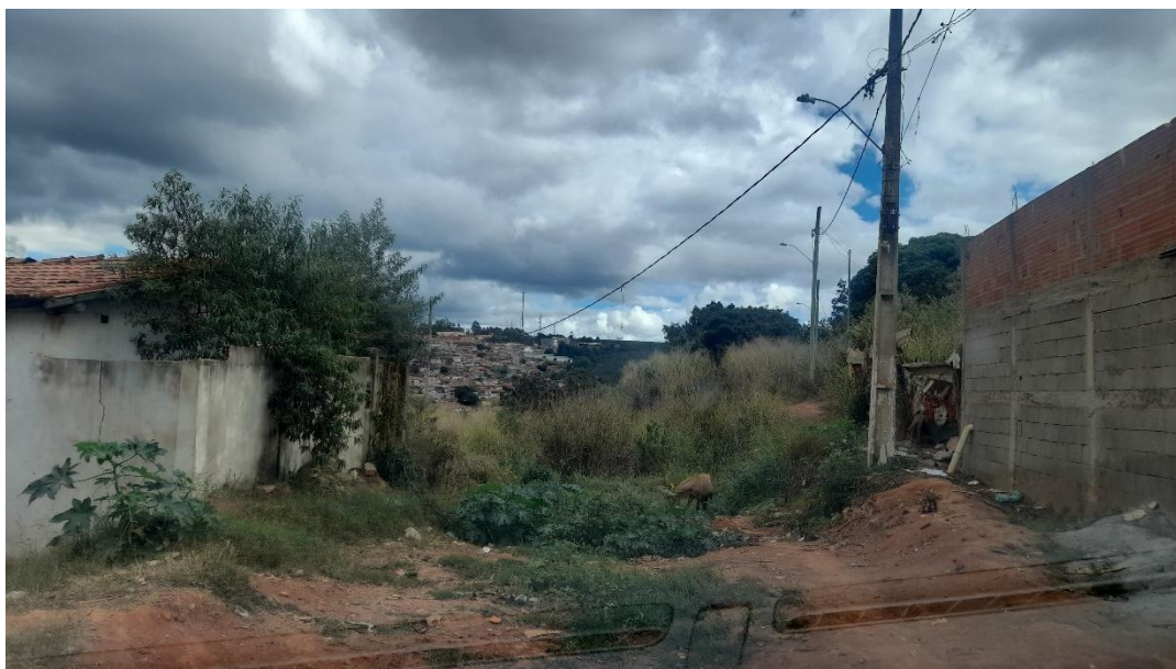
Foto 24 – Final da rua deca Abrantes, onde está se formando a voçoroca
