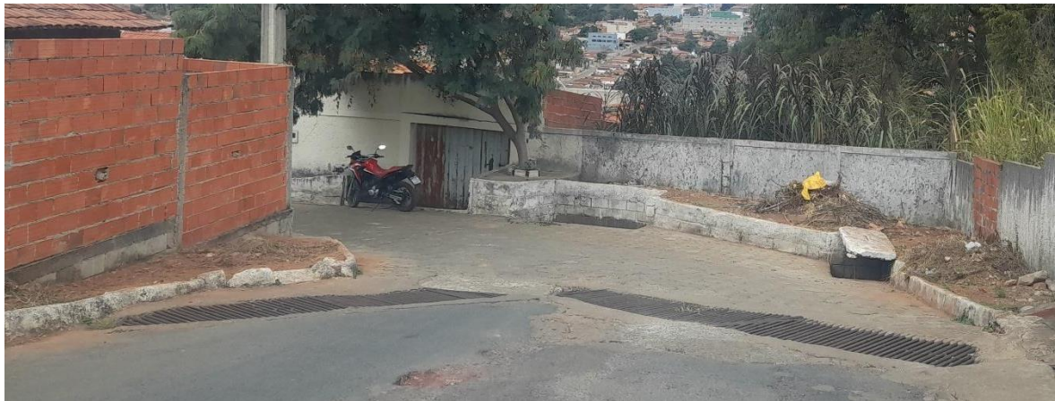
Foto 19 – Captação de água de chuva por meio de grelhas (final da rua Três Marias)
