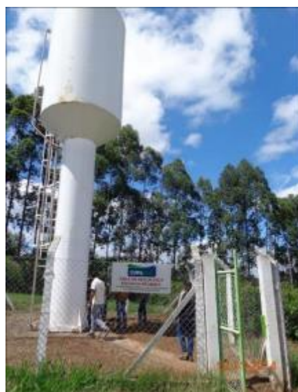
Foto 13 – Reservatório elevado com capacidade de 30m 3
