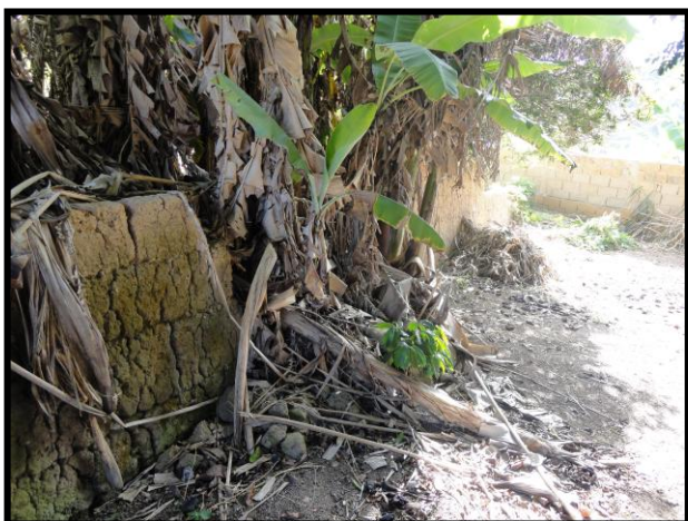
Pés de Bananeiras tampando o muro
