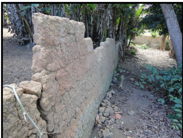
Muro fragmentado em alguns trechos
