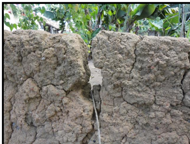
Detalhe das rachaduras
