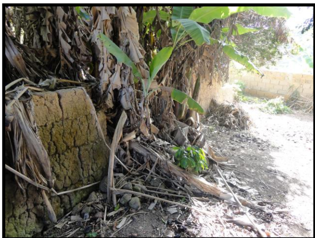
Pés de Bananeiras tampando o muro
