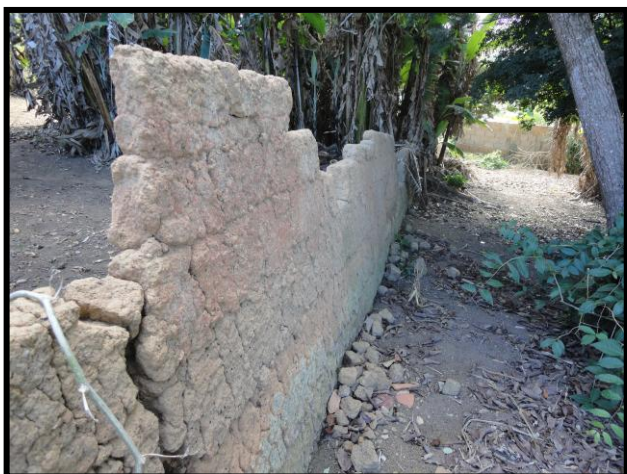
Muro fragmentado em alguns trechos
