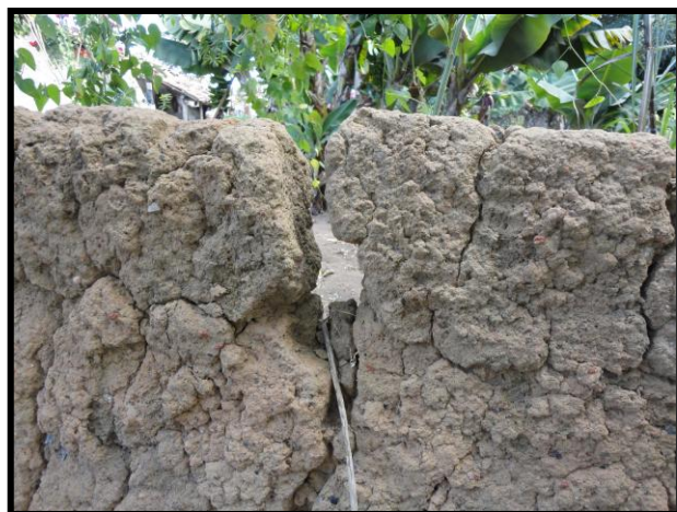
Detalhe das rachaduras
