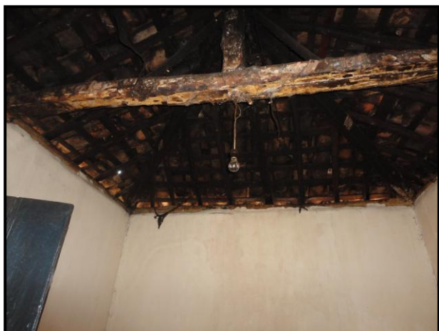
Parte do telhado sem forro
