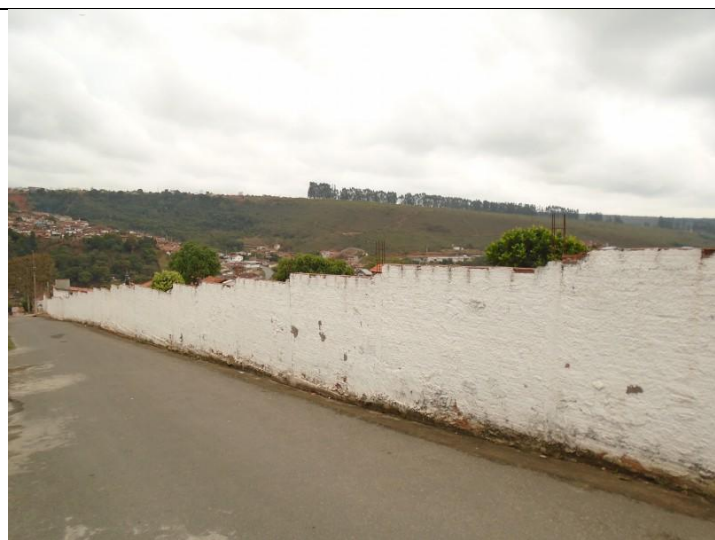
Cemitério Municipal de Capelinha – Muro à fachada frontal. Fotógrafo: Pedro Alcântara. Data: 20/06/2018. Fotografias: Digitais.
