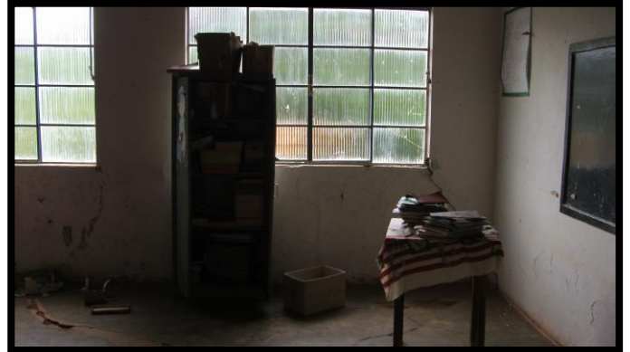
Rachaduras na parede na parte interna
