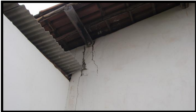
Rachaduras na parede do lado externo: Detalhe Beiral
