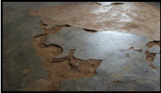
Piso em péssimo estado de conservação
