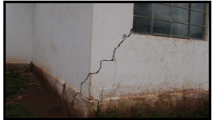
Rachadura na parede do lado externo, prolongando-se do alicerce à janela
