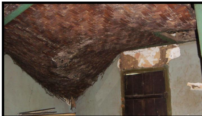
Forro de esteira caindo em um dos quartos
