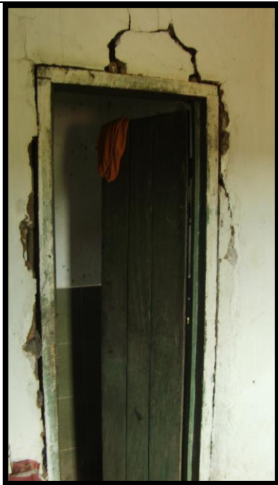
Parte Interna da Casa, rachaduras e trincas próximas as esquadrias da porta.
