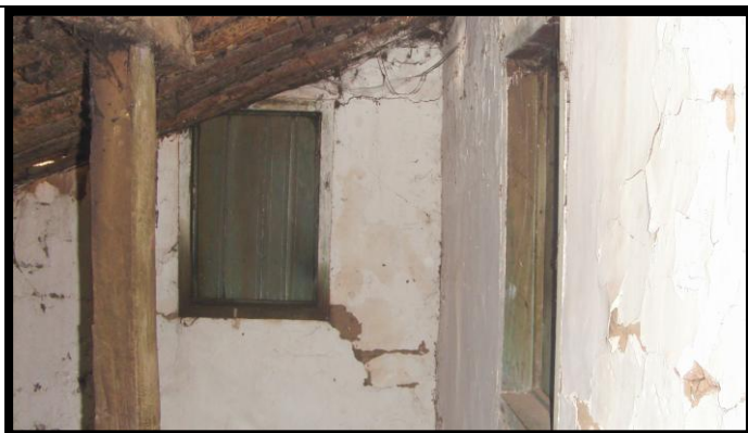
Cômodo anexo: Sujidades nas paredes
