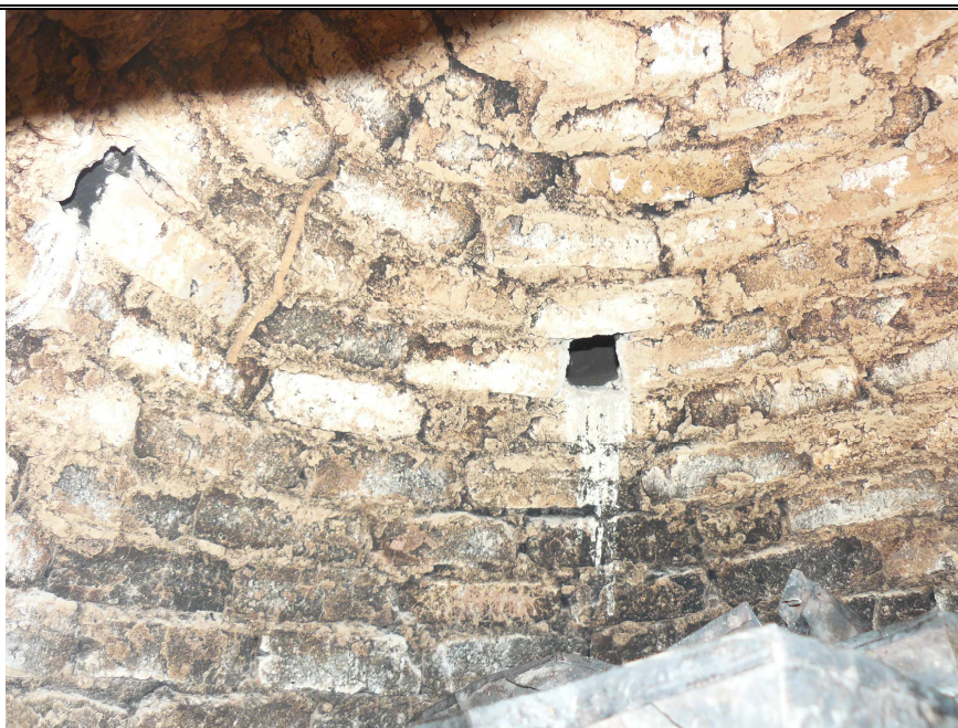
Foto 14- Fazenda Sr. Antônio- Vista Interna do Forno
