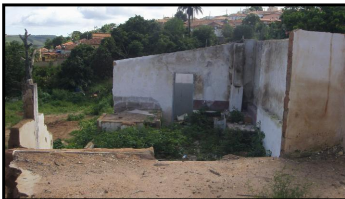
Restante da estrutura que ainda não ruiu
