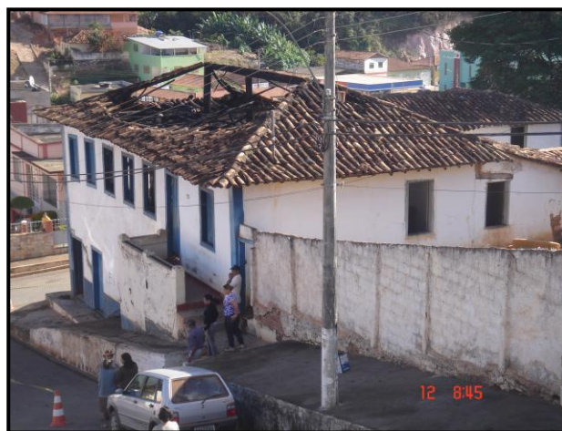
Casarão após incêndio
