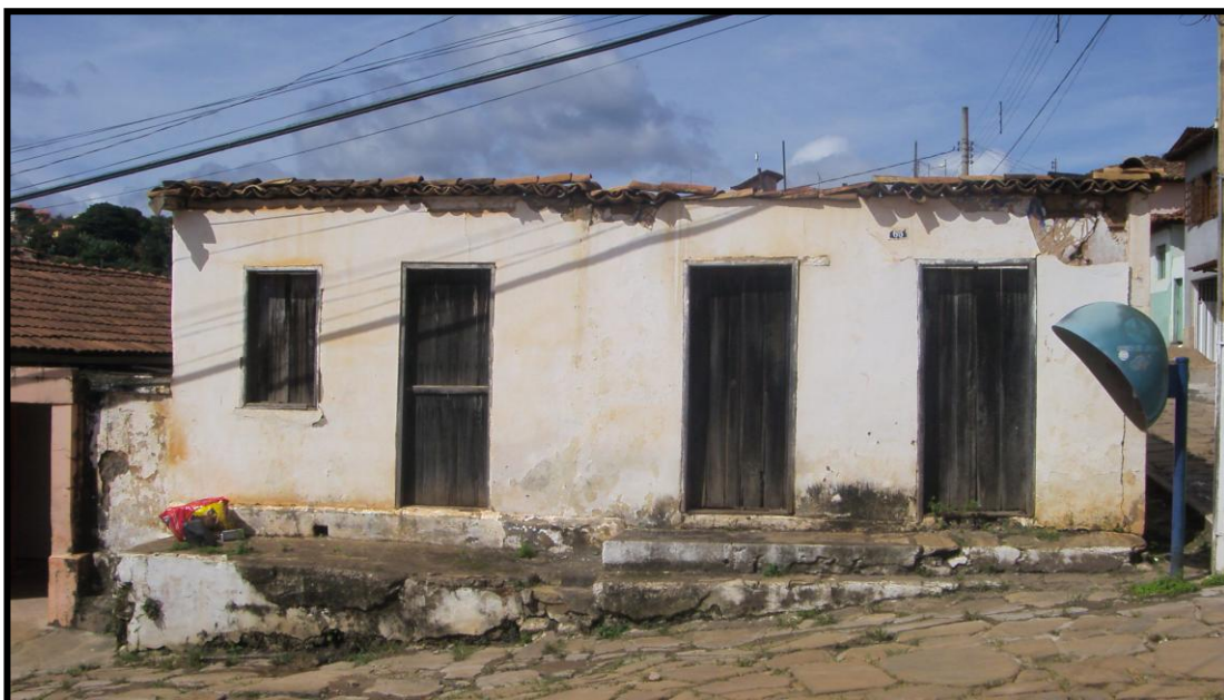
Situação atual da Fachada do Bem, nota-se a ausência do Frontão
